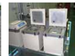
洗浄用灯油浄化装置
