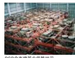
PCB含有機器の保管状況
