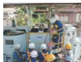
排水水処理装置のメンテナンス
