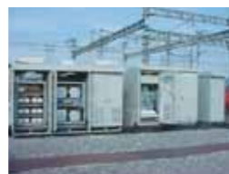
電力補完装置
