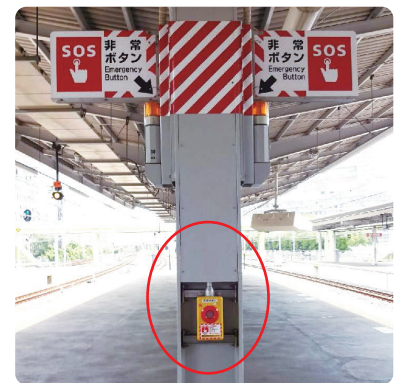
ホーム非常ボタン
